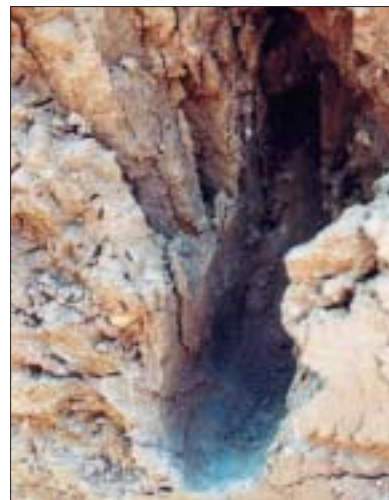
Lissage de la dent + fissuration en triangle.
