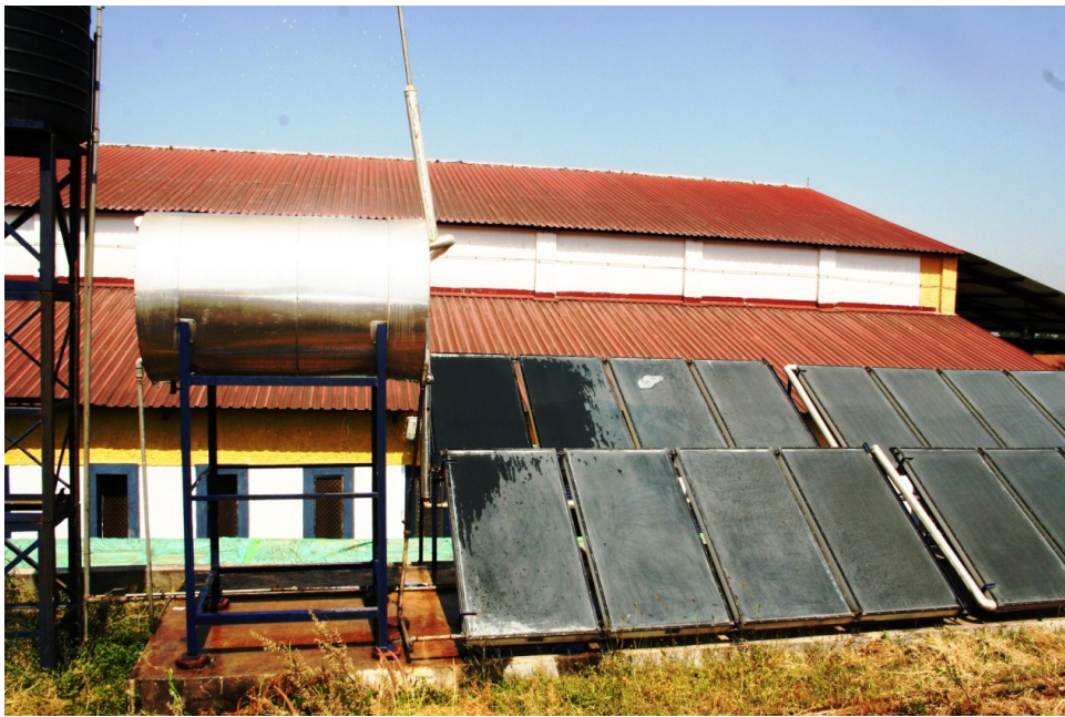
Figure 4 : Panneaux solaires de production d'eau chaude (Source : IFV Epernay)
